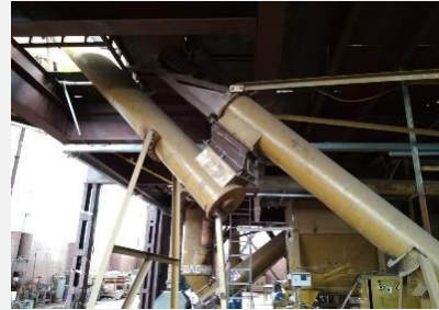
Общий вид линии
